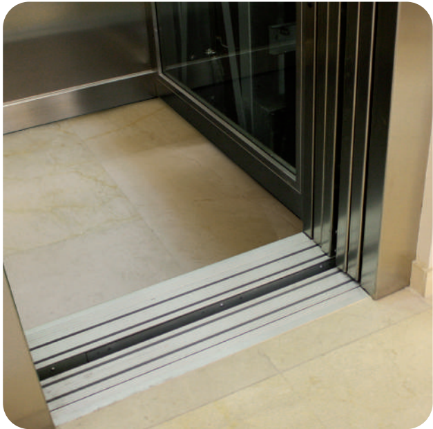
Suelo de la cabina
